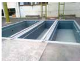
Lovilni bazeni (sekundarni zadrževalni sistemi) za skladiščenje kemikalij
